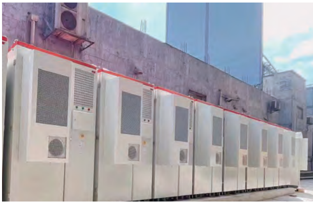
1.4MW/3.01MWh 溢泉科技园用户侧储能
