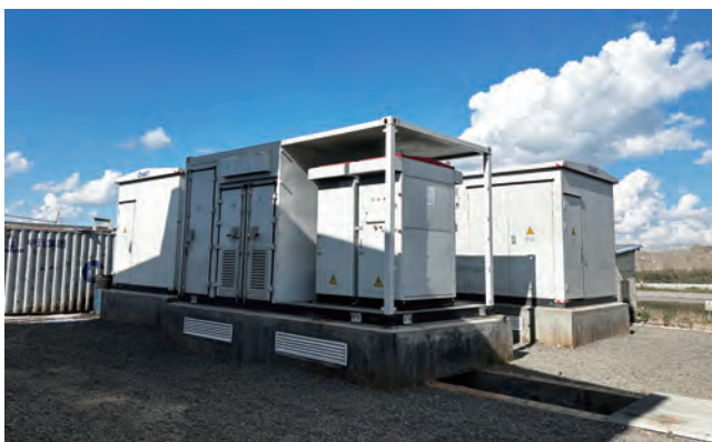
3.5MW/10MWh 华友钴业刚果金LuKuni工厂构网储能项目
