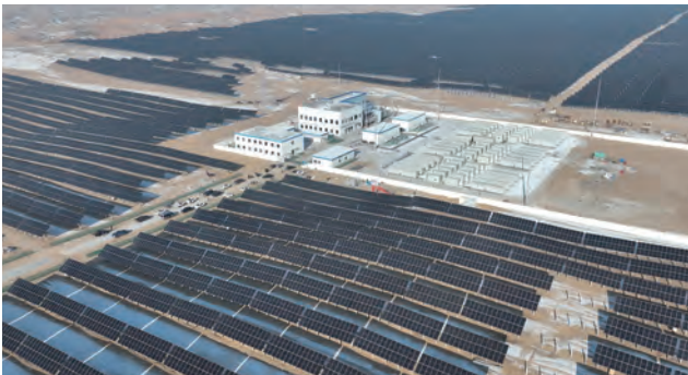
60MW/120MWh 中核镶黄旗40万千瓦风光储一体化基地项目配储
