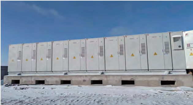
15MW/60MWh 山丹县东东北滩100MW光伏发电项目配储
