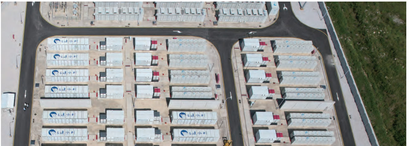
103MW/206MWh 三峡水利广西平果共享储能电站
