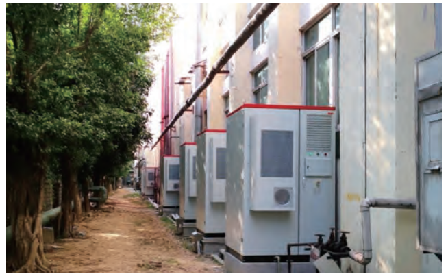
700kW/1505kWh 广州悦康生物制药公司工商业储能项目
