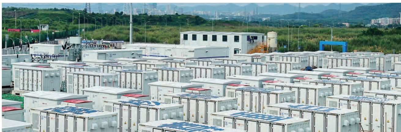
100MW/200MWh 中核汇能重庆西永综保区储能电站
