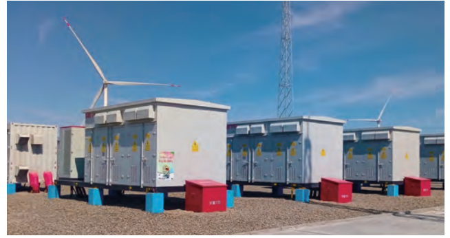
10MW/20MWh 昌吉国投鑫能木垒四十个井子100MW风电项目配储
