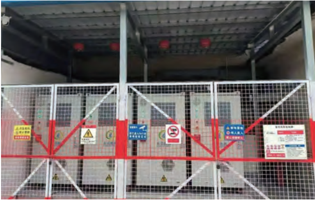
540kW/1044kWh 东莞能源-东凌新型建材储能项目
