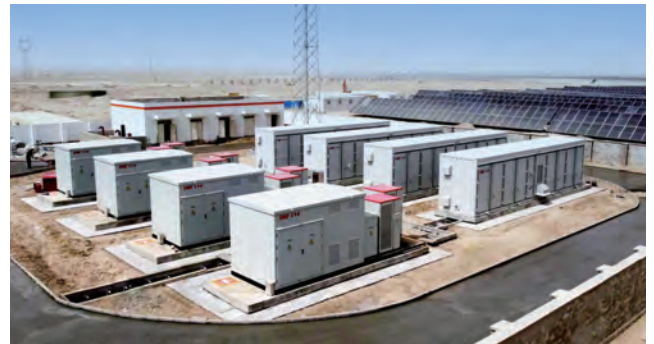
10MW/20MWh 天合巴州能源尉犁县100MW光伏发电项目配储
