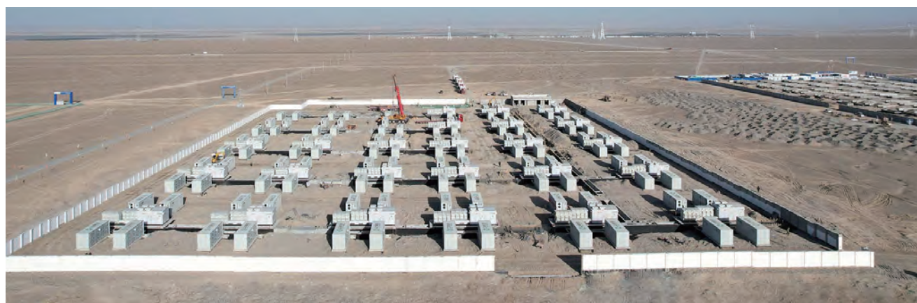
200MW/800MWh 立新民丰县独立储能项目
