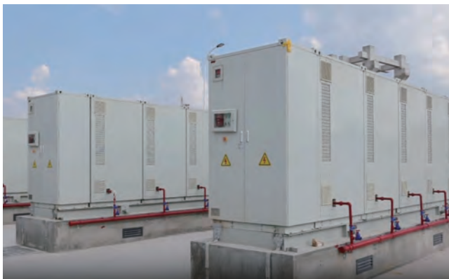
4.95MW/10.07MWh 浙江三美化工用户侧储能项目
