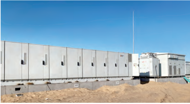
40MW/80MWh 国电投内蒙古磴口县100MW光伏治沙项目配储
