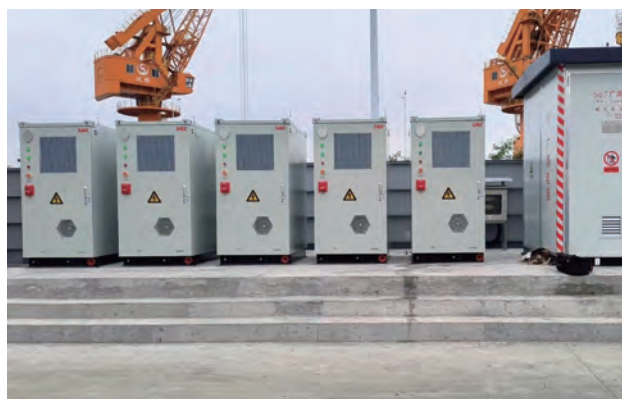
675kW/1305kWh 双桥（广州）有限公司码头绿电改造项目
