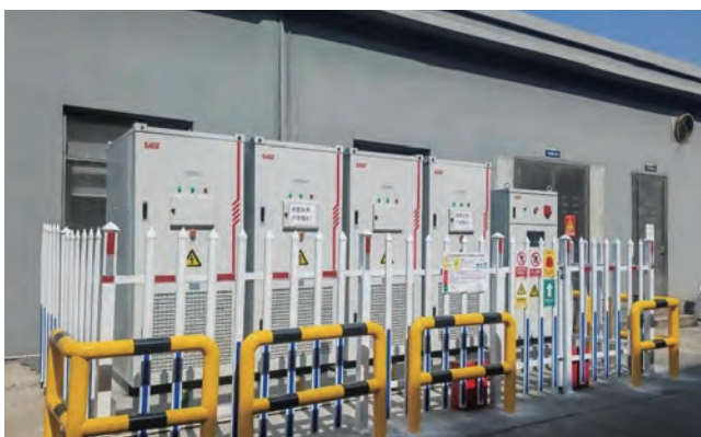
3MW/6.99MWh 浙江玉环苏强格工商业储能项目
