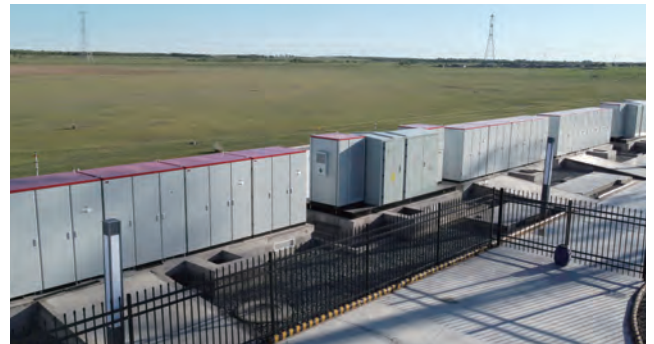
5MW/5MWh 康保智能微电网示范工程100MW项目配储
