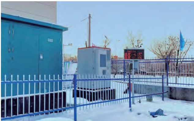
2.9MW/6.23MWh 新疆伊宁市光储充换放一体化项目
