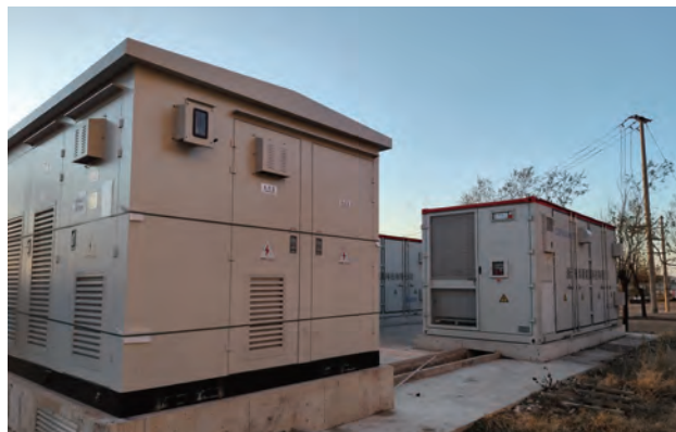
10MW/20MWh 驰库新能源唐山用户侧储能项目
