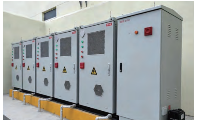
675kW/1305kWh 宿迁益客旭阳饲料储能项目
