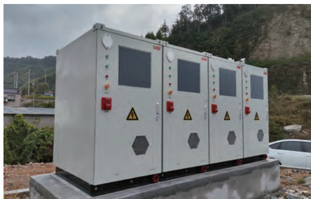
540kW/1044kWh 武义县谨同重卡快充站储能项目
