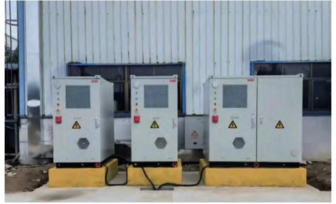
675kW/2088kWh 江西乐昇合成新材料储能项目
