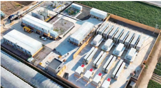
12MW/24MWh 国能电力高密胶河生态发展区农光互补项目配储
