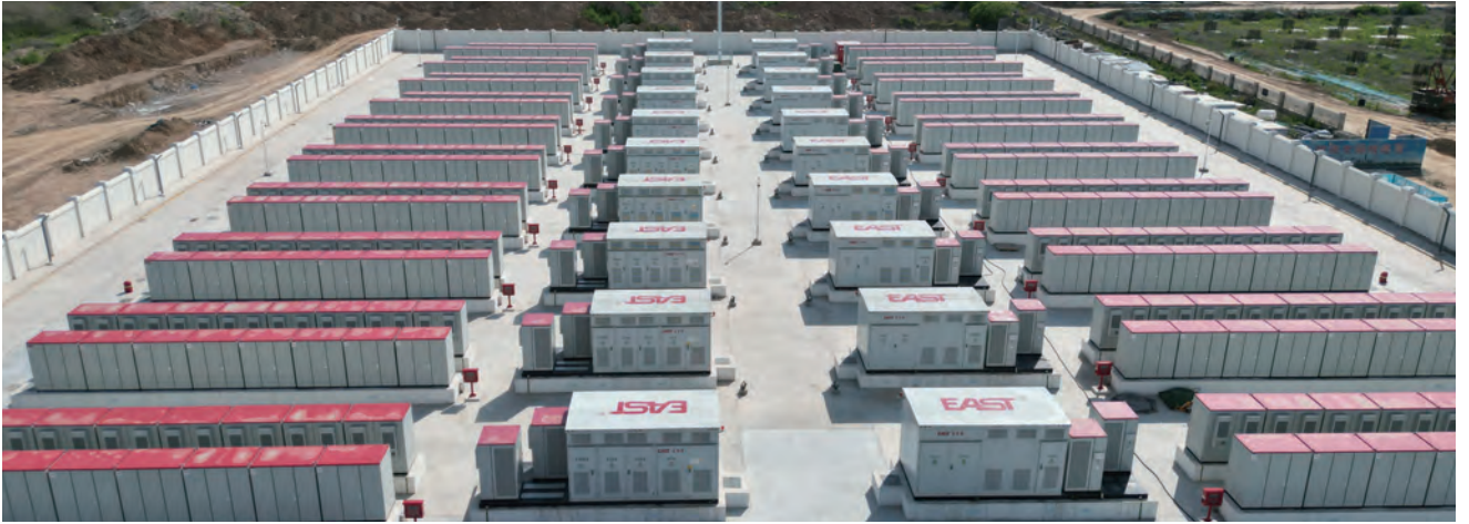
50MW/100MWh 三门峡市湖滨区共享储能电站
