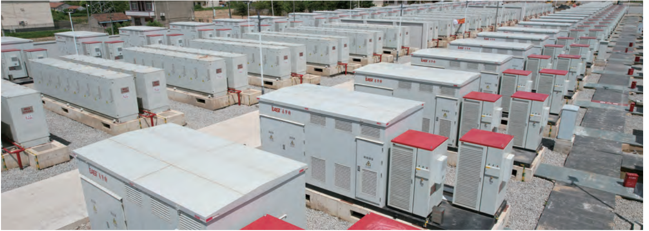
155MW/369.52MWh 易事特启东储能电站
