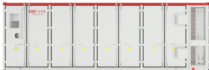
◎ 6.7MWh液冷电池集装箱
