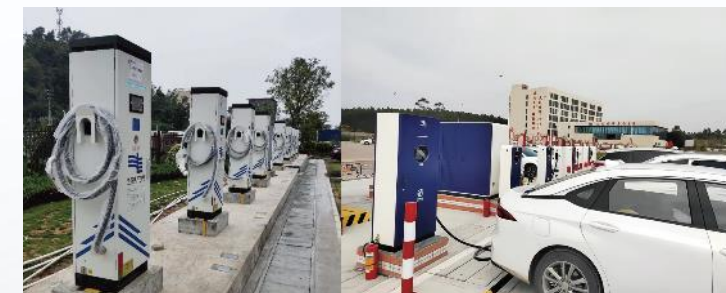
南方电网 南方电网充电站
