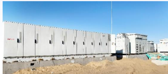
40MW/80MWh | 国电投内蒙古磴口光伏治沙项目
