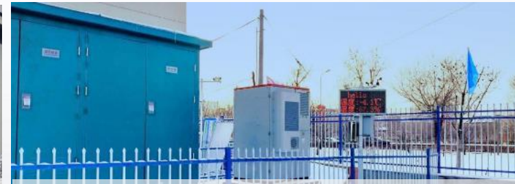
2.9MW/6.23MWh | 新疆伊宁市光储充换放
