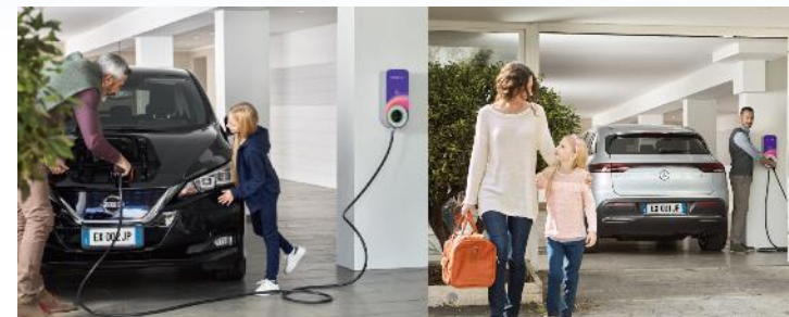
电力公司 意大利电力公司EnelX交流桩
