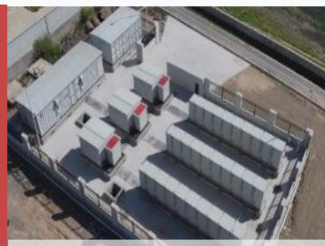
5MW/10MWh | 浙江三美化工
