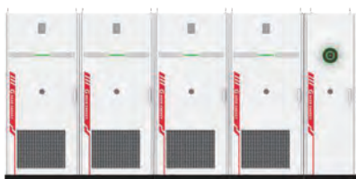
直流侧灵活扩容(1配电柜+4电池柜) 130kW/261-1044kWh 系统
